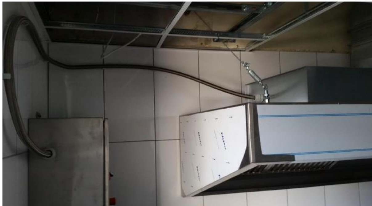
Abbildung 2 montierte Anlage - Teflonschlauch zur Haube (Quelle Foto: RL Raumluftechnik GmbH)
